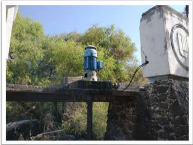
Figura 6. Sistema de bombeo de la Colonia Progreso en Morelos
